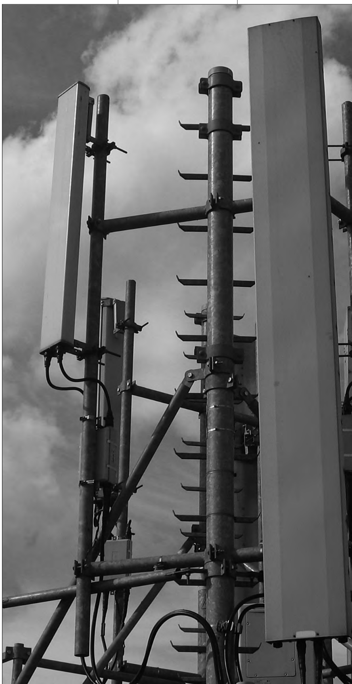
La ampliación de su acuerdo en Reino Unido trae consigo que Telefónica y Vodafone además de compartir la estructura física de la red compartirán la parte activa de la misma, como por ejemplo las antenas.
