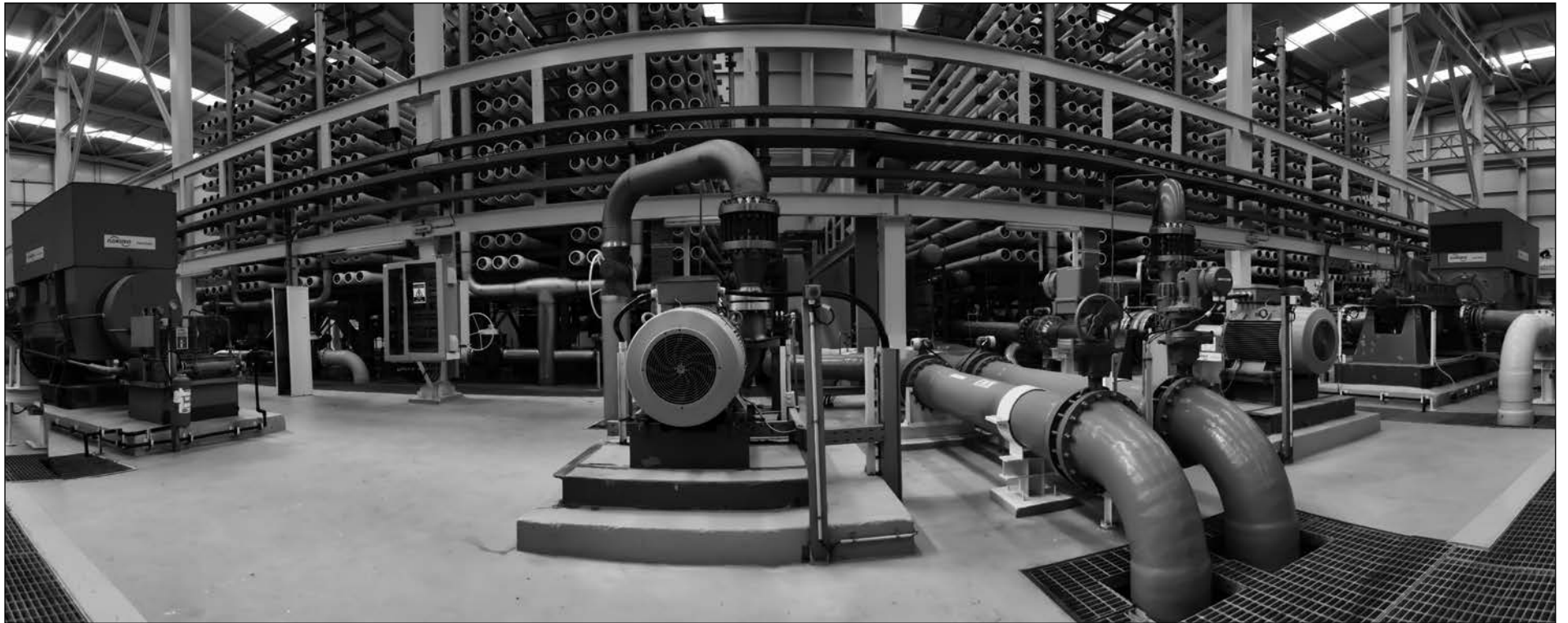
La desaladora de Cap Djinet, en Argelia, ha producido unos 25 millones de metros cúbicos de agua.
