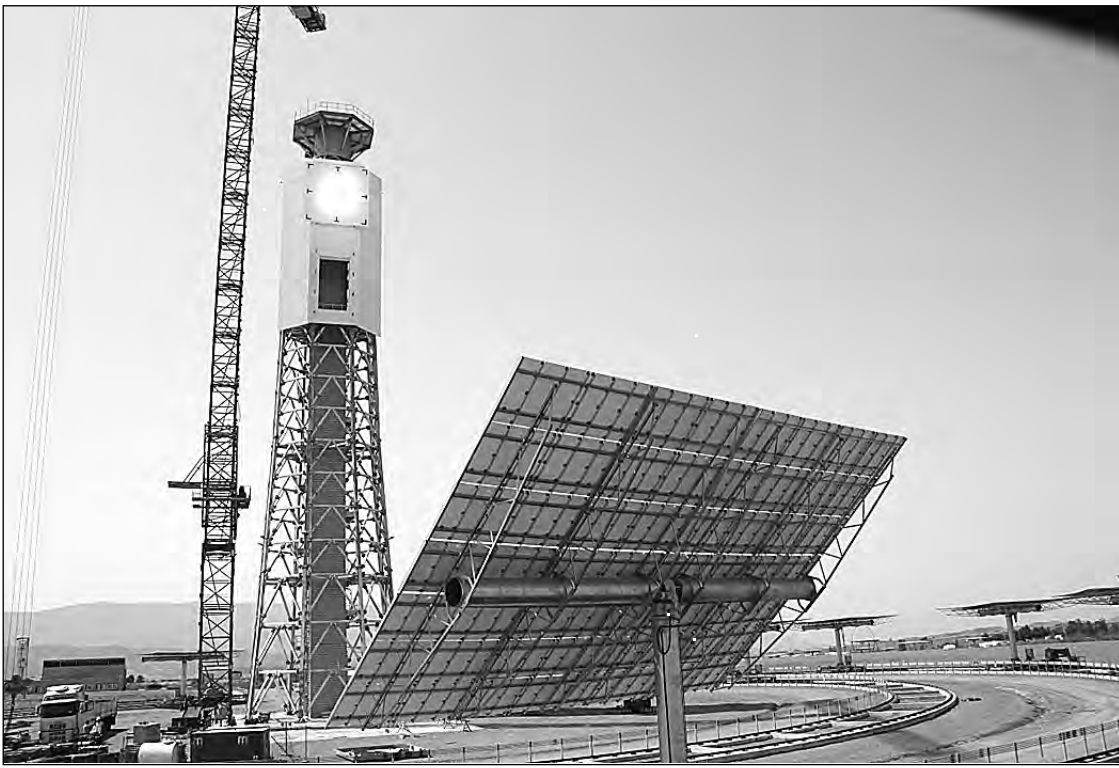
La plataforma multi-receptora ya corona la torre de la instalación solar de geometría variable del CTAER.
